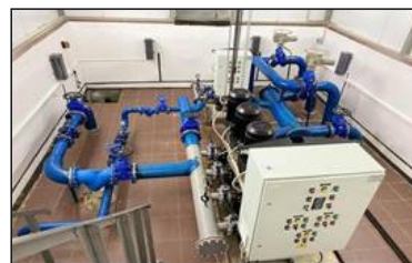
Насосная станция Макинского ГВ (Акмолинская область)
